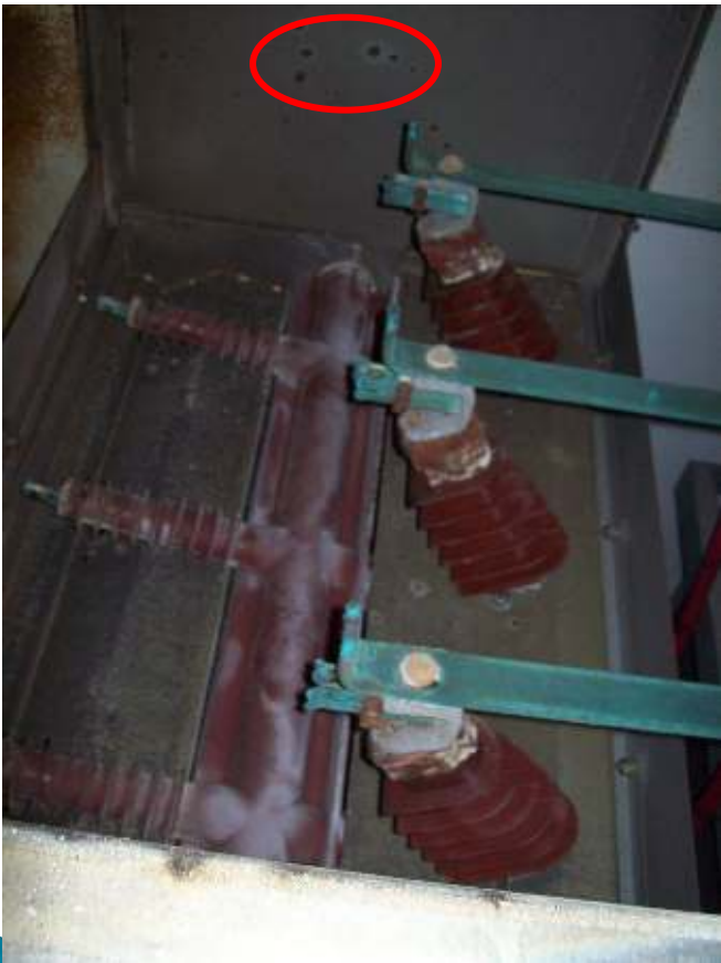
Tracce di archi elettrici
